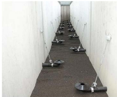
Installation de traitement semi- centralisée (© OST)
