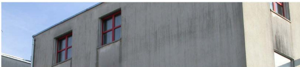
Absence de débord de toiture Photo: © Michael Burkhardt
