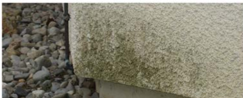
Algues et champignons sur une façade de maison Photo :© H. Bartholemy/ Bundesverband Farbe Gestaltung Bautenschutz
