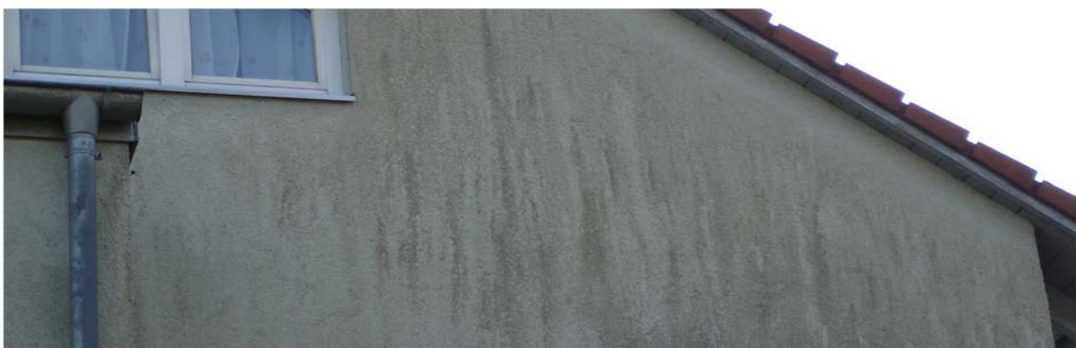
Algues et champignons sur une façade de maison Photo :© H. Bartholemy/ Bundesverband Farbe Gestaltung Bautenschutz
